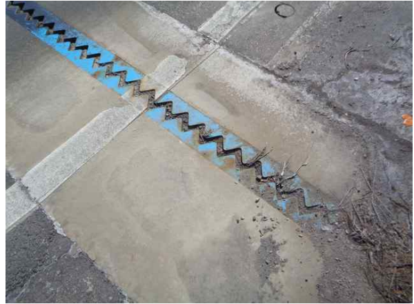
신축이음 A1 후타재 균열(0.3mm이상)(L=10.90m, 24EA)
