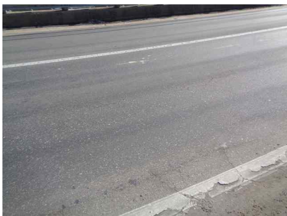
교면포장 S1 포장균열(L=1.40m, 1EA)
