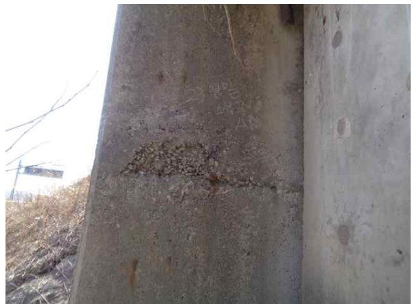
교대 A1 표면박락(골재노출) (0.4×0.6)
