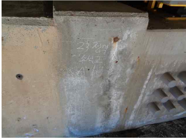
교대 A2 잡철물 부식 및 녹오염(0.1×0.1)
