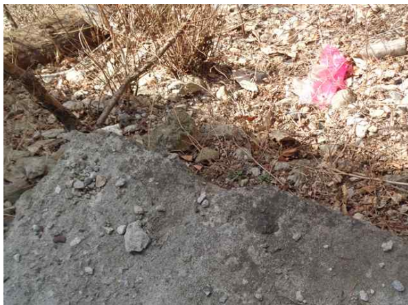
교대 A2 기초 파손(0.2×0.3)
